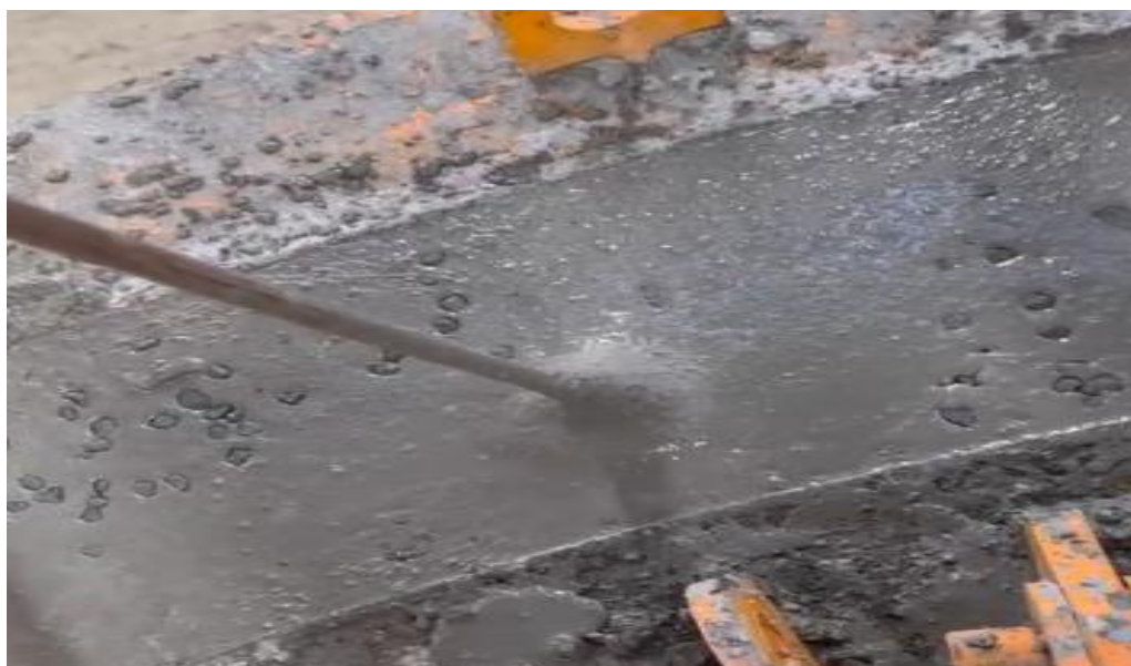
图3 立模表面浮浆过厚
