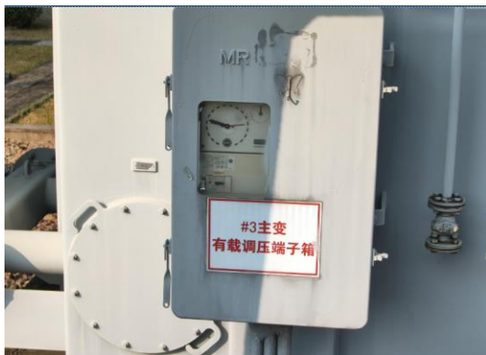
图 E. 1. 2-7 有载调压档位拍摄示例
