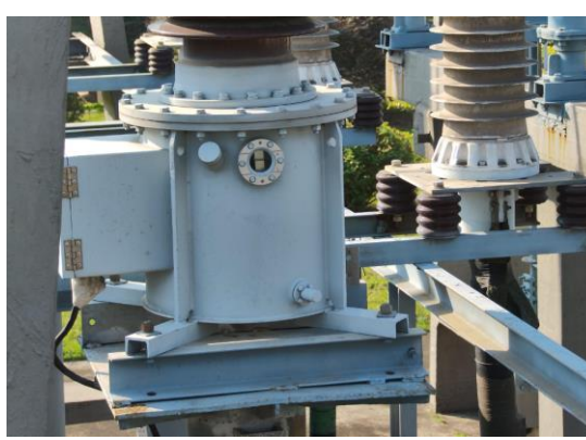
图 E. 2. 2-4 线路 PT 油位拍摄示例
