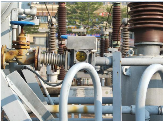
图 E. 1. 2-1 瓦斯继电器拍摄示例
