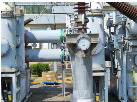
图 E. 2. 2-3 泄漏电流表拍摄示例
