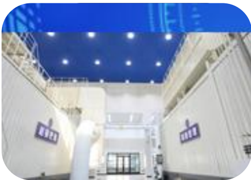
供热站改造后
