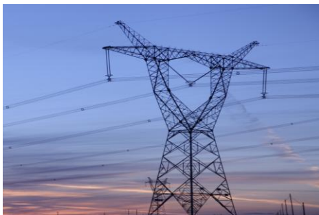
负荷峰谷差增大电网负担
