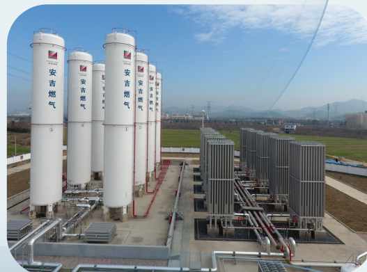
管道燃气门站
