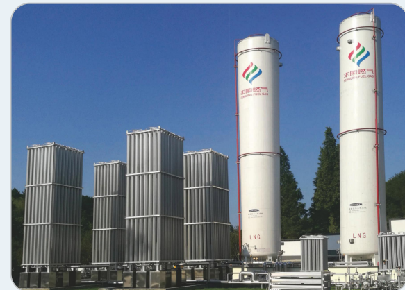
液化天然气储配站
