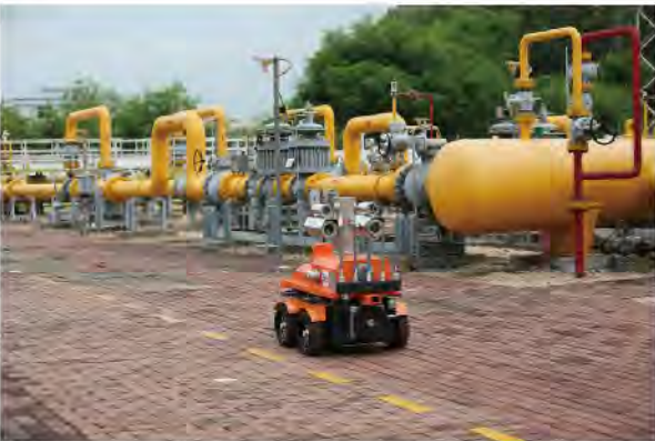
图2 燃气场站巡检机器人
