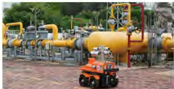
图2. 深圳燃气 5G+ 机器人与 AI 监控实现燃气场站 24h 安全可控
