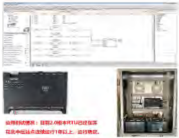
图 14 在深圳燃气场站实地运行的 PLC 和 RTU
