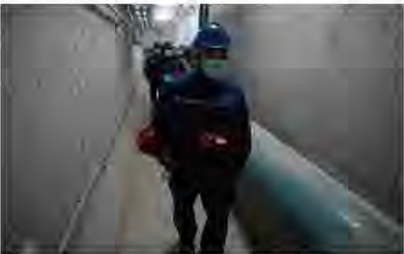
图1 燃气管廊人工巡检模式
